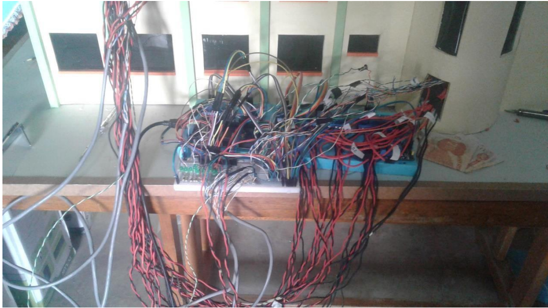
Figura 12. Acabado de gabinete de placa Arduino con las conexiones listas
